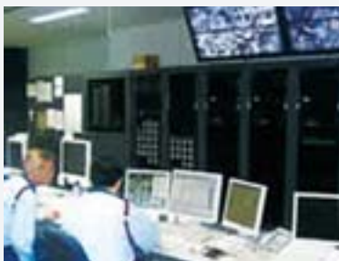
大丸東京店の防災センターでは各種モニターで集中コントロールし全館の安全確認を行っています。
