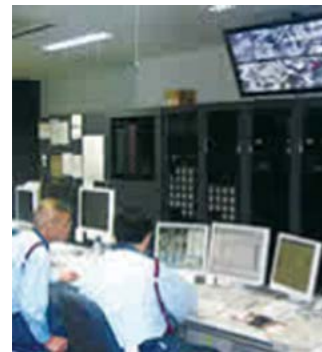
大丸東京店の防災センターでは、各種モニターで集中コントロールし全館の安全確認を行っています。
