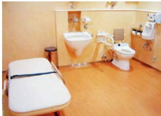
大丸梅田店3階の多目的トイレ
