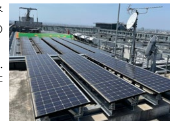
渋谷PARCO屋上に設置されている太陽光パネル
