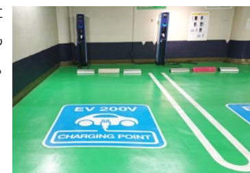
エンゼルパーク駐車場のEV充電スタンド
