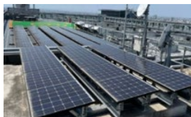
渋谷PARCO屋上に設置されている太陽光パネル
