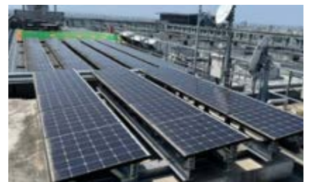
渋谷PARCO屋上に設置されている太陽光パネル
